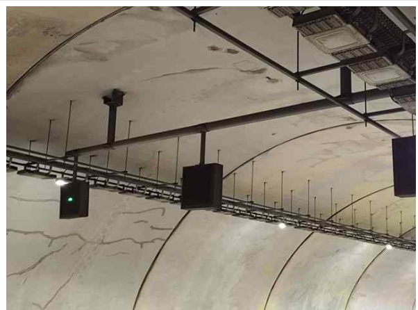
신호기, 조명시설 전경
